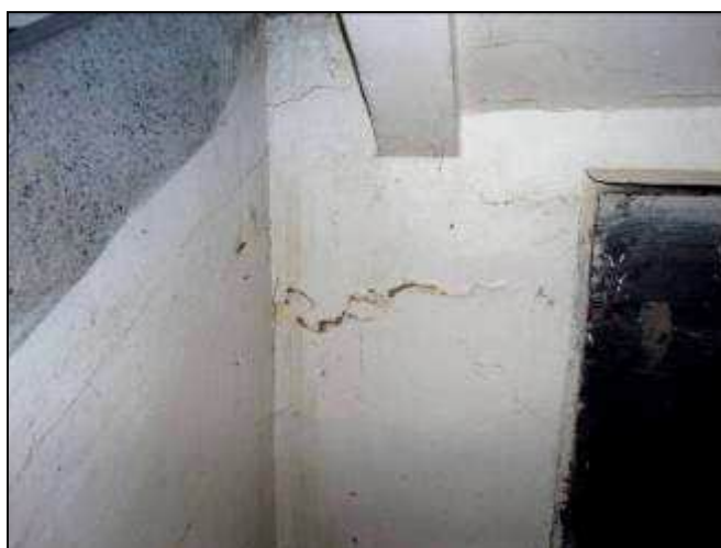
Nejedlého 2 – Trhliny pod schodištěm v 1.PP
