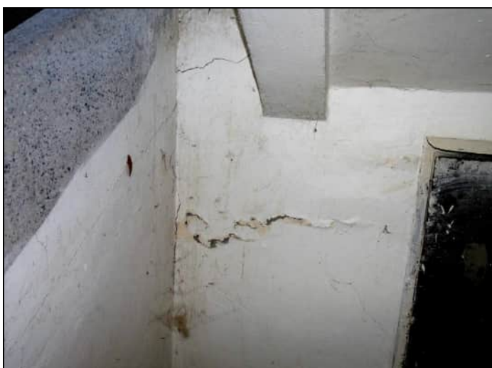
Nejedlého 2 – Trhliny pod schodištěm v 1.PP
