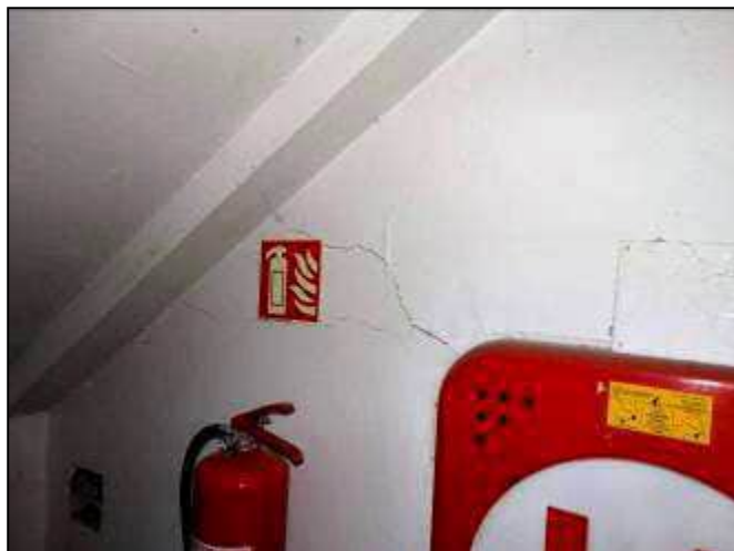
Nejedlého 2 – Trhlina u hydrantu v 1.PP
