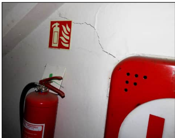
Nejedlého 2 – Trhlina u hydrantu v 1.PP
