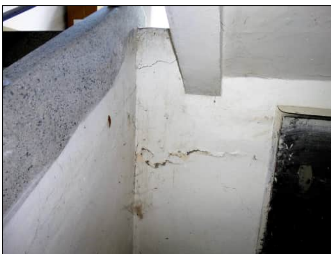
Nejedlého 2 – Trhliny pod schodištěm v 1.PP
