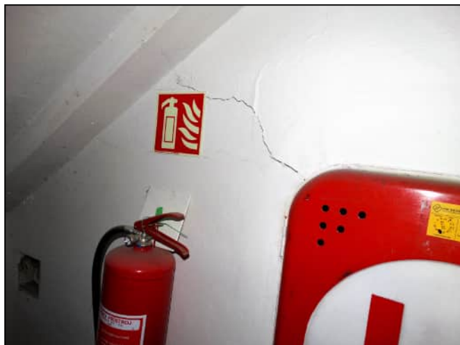
Nejedlého 2 – Trhlina u hydrantu v 1.PP
