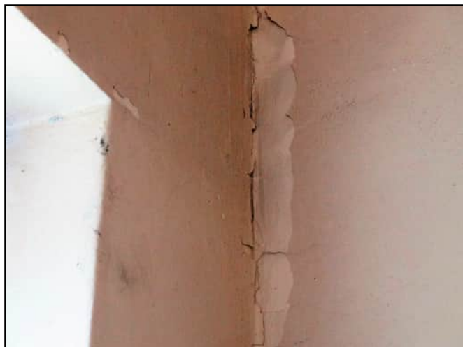
Nejedlého 6 – Trhlina v koutě u okna na schodišti
