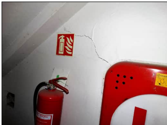
Nejedlého 2 – Trhlina u hydrantu v 1.PP
