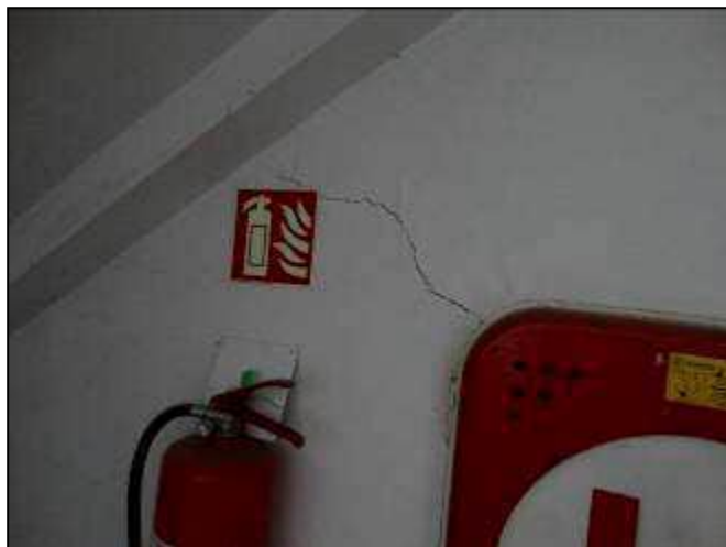
Nejedlého 2 - Trhlina u hydrantu v 1.PP
