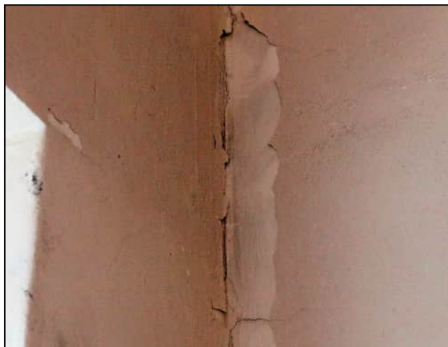
Nejedlého 6 – Trhlina v koutě u okna na schodišti
