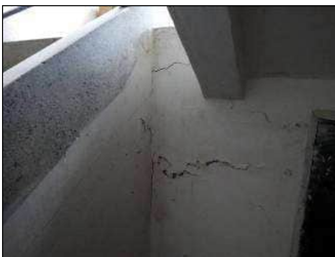
Nejedlého 2 – Trhliny pod schodištěm v 1.PP
