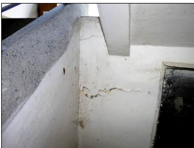
Nejedlého 2 – Trhliny pod schodištěm v 1.PP
